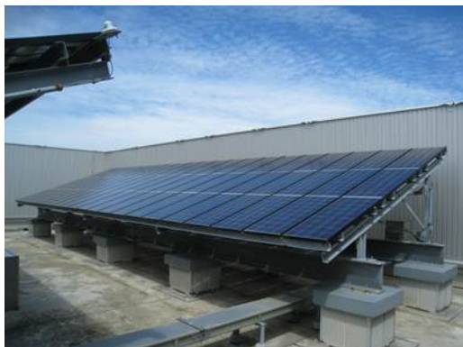
太陽光発電設備（防災センター屋上）
